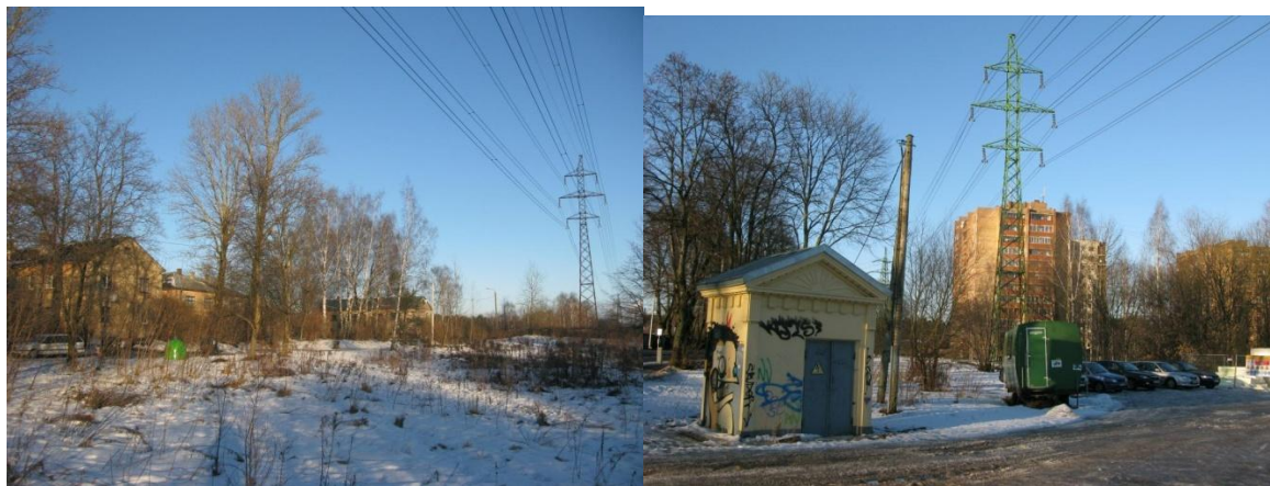
33., 34.attēls. Esošā augstsprieguma elektrolīnija pie Stendera ielas un Kokneses prospektā. Foto M.Kalvāne, 2013.
